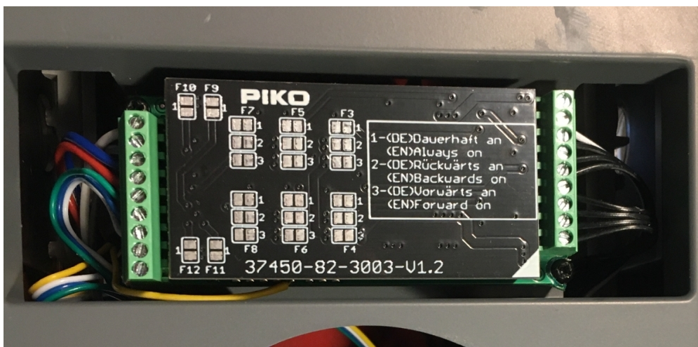
Bild 3 : Originalverkabelung an PIKO-Schnittstelle
